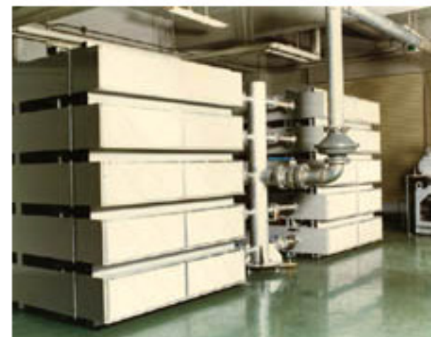
大阪ガスの実験燃焼炉に据え付けられた酸素富化膜の実例。10個のモジュールで常時、酸素濃度の高い空気を送り込んでいる。
