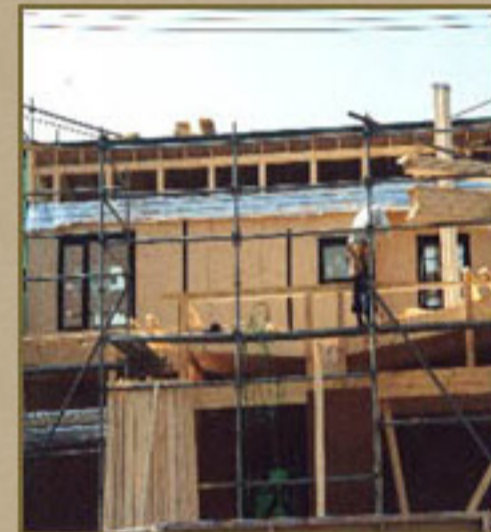
真空断熱材を使用した札幌実験住宅
