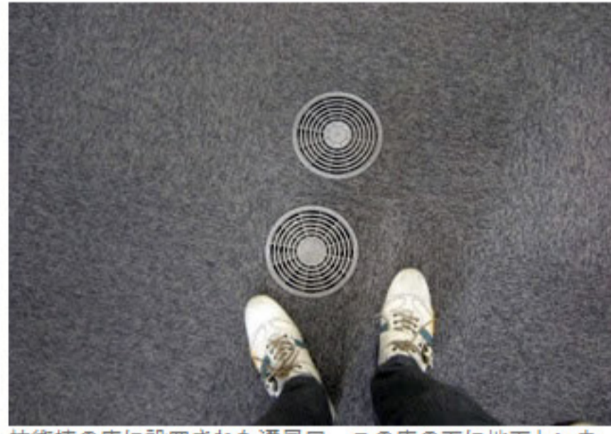
技術棟の床に設置された通風口。この床の下に地下トンネルがある。
