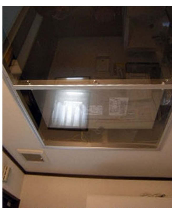
バスルームの天井に設置された換気システムの本体。
