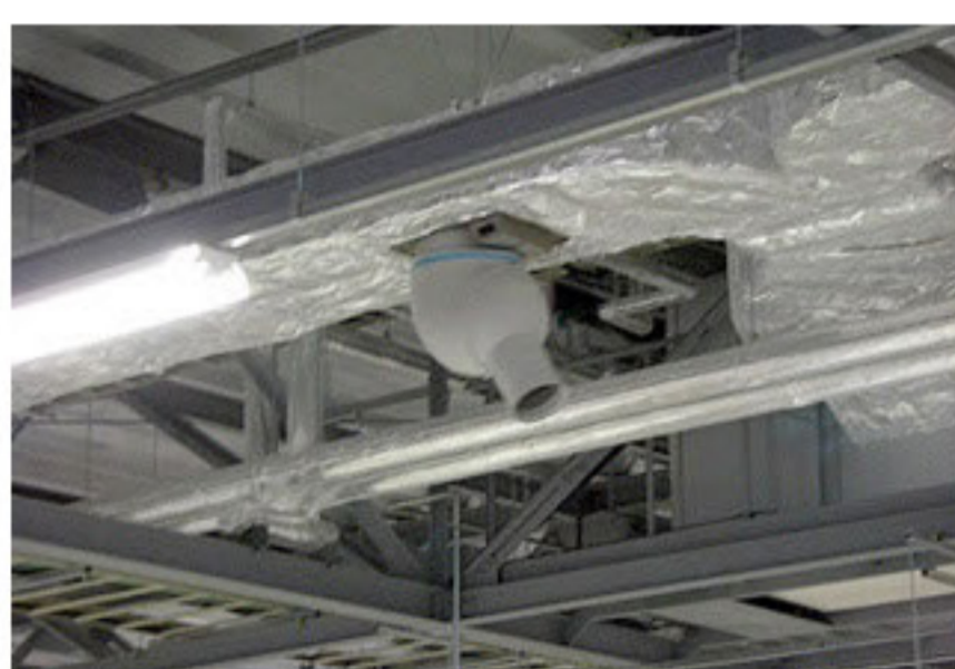
天井に設置されたノズル。360度ぐるぐる回る。
