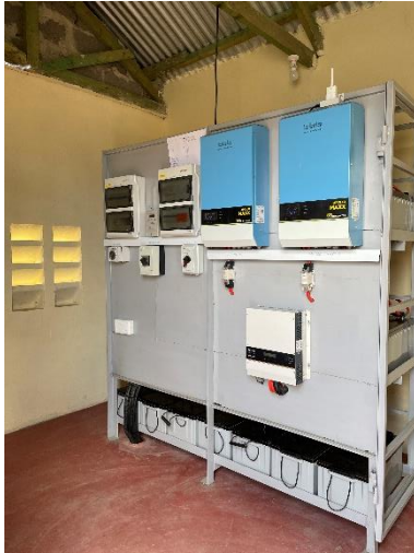
バッテリーとパネルが設置された PSS 建屋の内部の様子
