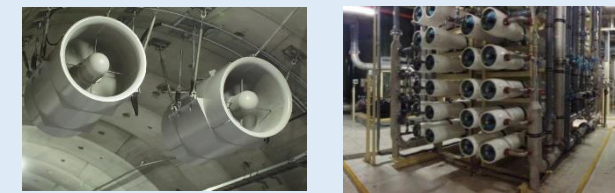
トンネル換気浄化 水処理設備
