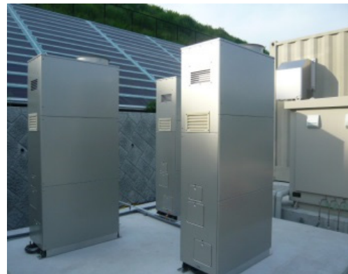
第3図 実証試験中の純水素燃料電池
